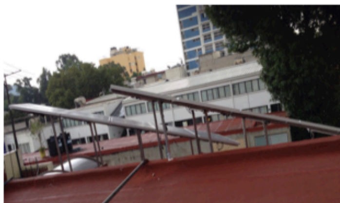
Lindavista, CDMX: 10 módulos, 2.5 KWp -P4541
