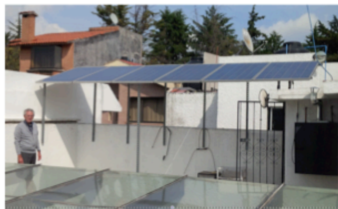
Huixquilucan, Edo. Mex.: 4 + 2 módulos, 1.5 KWp – P4425/4718
