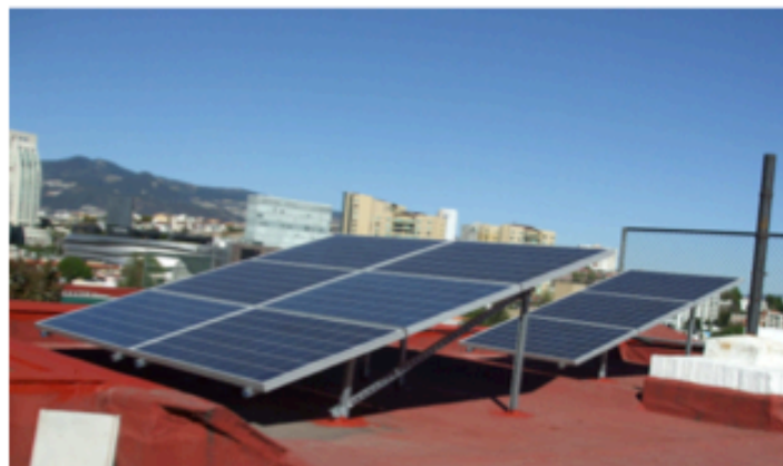
Huixquilucan, Edo. Mex.: 9 módulos, 2.25 KWp -P4516
