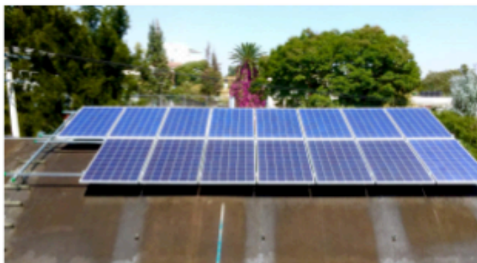
Las Aguilas, CDMX: 15 módulos, 3.9 KWp
