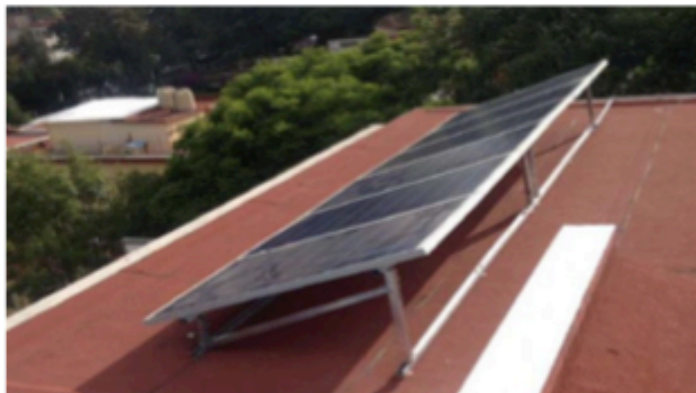
Las Aguilas, CDMX: 6 módulos, 1.5 KWp
