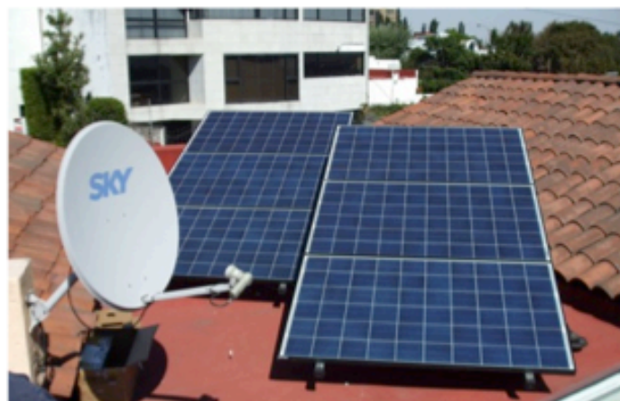
Bosques de las Lomas, CDMX: 4+2=6 módulos, 1.5 KWp –P4220/4940
