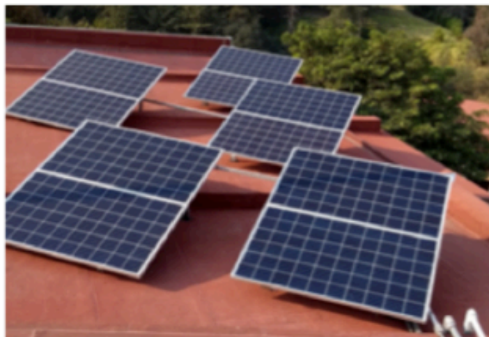
Bosques de las Lomas, CDMX: 10 módulos, 2.5 KWp – P4838
