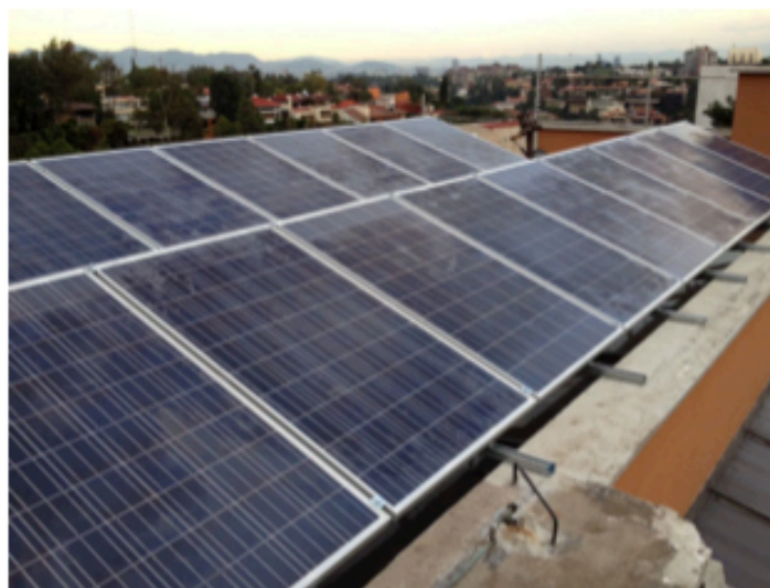
Bosques de las Lomas, CDMX: 15 módulos, 3.75 KWp - P4800
