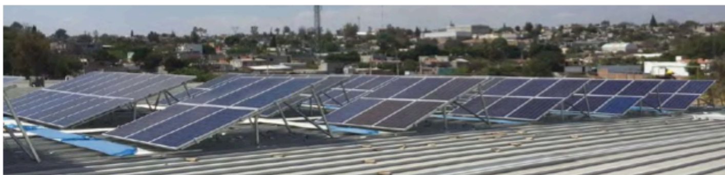
Querétaro, Qro: 115 módulos, 31 KWp -P4865
