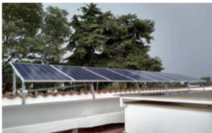
San Jerónimo, CDMX: 8 módulos, 2.2 KWp
