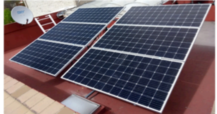
Huixquilucan, Edo. Mex: 6 módulos, 2.28 KWp - P4965
