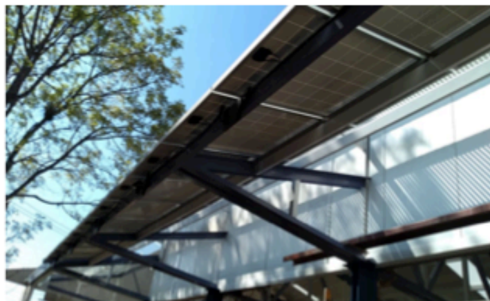
Valle de Bravo, Edo. Mex: 12 módulos, 3.3 KWp – P4849
