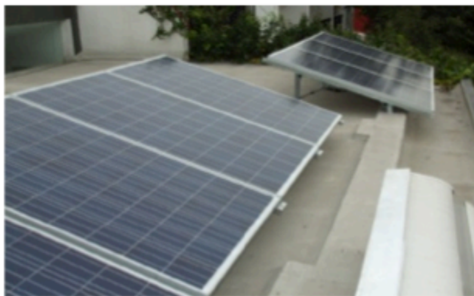
Las Águilas, CDMX: 9 módulos, 2.25 KWp -P4472
