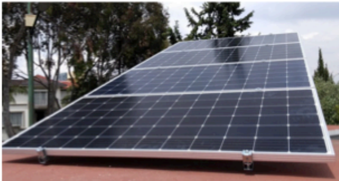
Bosques de las Lomas, CDMX: 4 módulos, 1.44 KWp - P4996
