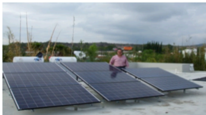
Querétaro, Qro: 8 módulos, 2.0 KWp – P4286
