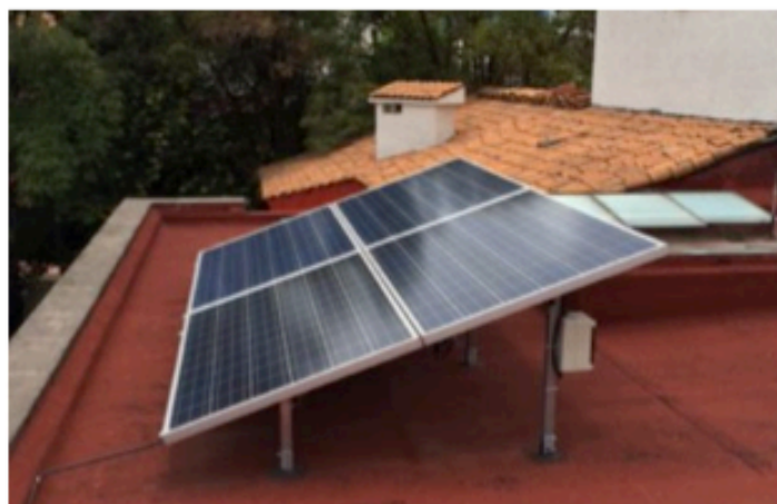
Huixquilucan, Edo. Mex: 4 módulos, 1.0 KWp - P 4705
