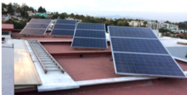
Olivar de los Padres, CDMX: 12 módulos, 3.0 KWp – P4809
