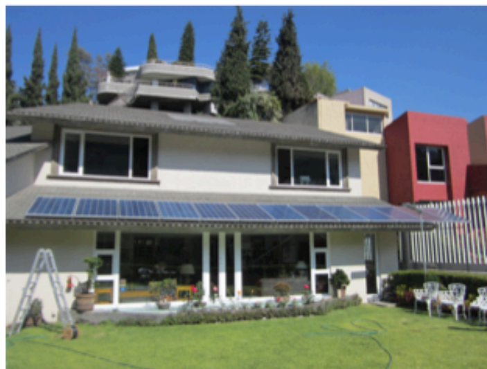
Bosques de las Lomas, CDMX: 13 módulos, 3.25 KWp -P4733
