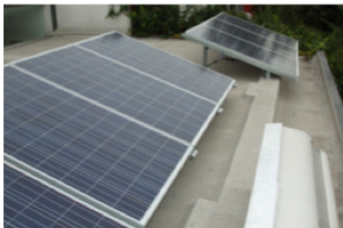
Las Aguilas, CDMX: 9 módulos, 2.25 KWp - P4472
