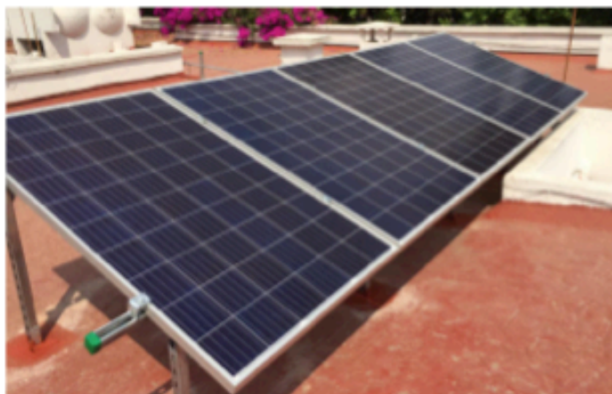
Coyoacán, CDMX: 5 módulos, 1.35 KWp
