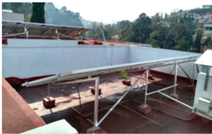
Real de las Palmas, CDMX: 10 módulos, 3.3 KWp – P4986
