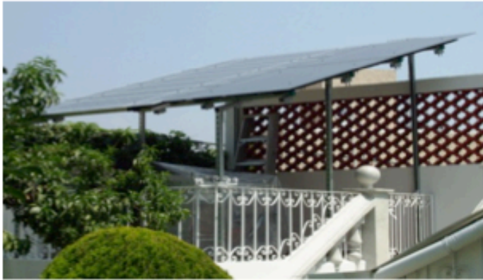
Huixquilucan, Edo. Mex: 6 módulos, 1.5 KWp - P4028
