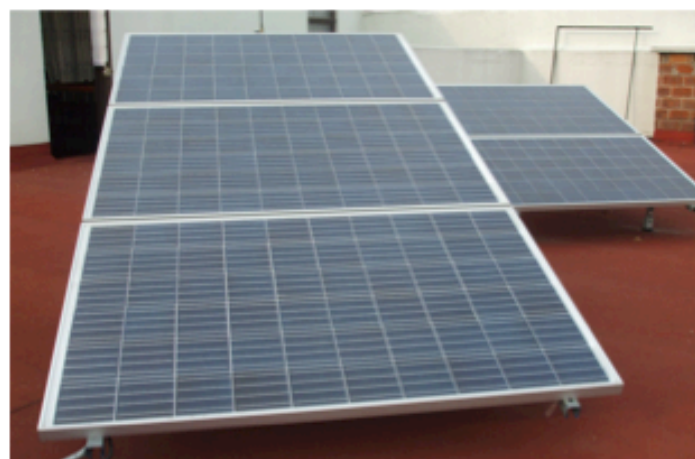
Lomas de Bezars, CDMX: 5 módulos, 1.25 KWp -P4491
