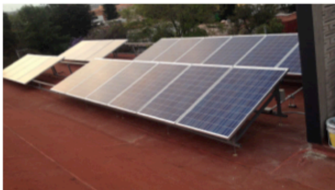
Las Aguilas, CDMX: 17 módulos, 6.12 KWp
