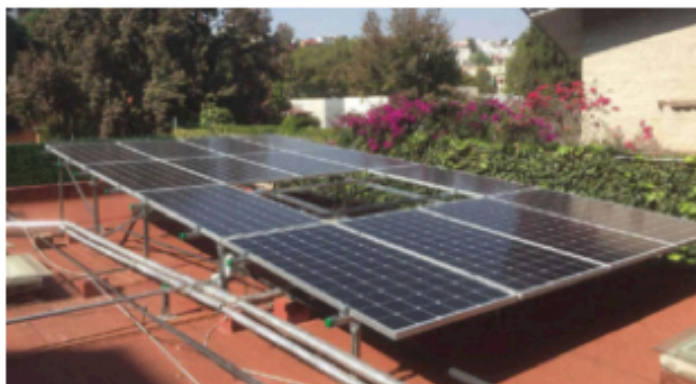
Bosques de las Lomas, CDMX: 14 módulos, 4.83 KWp
